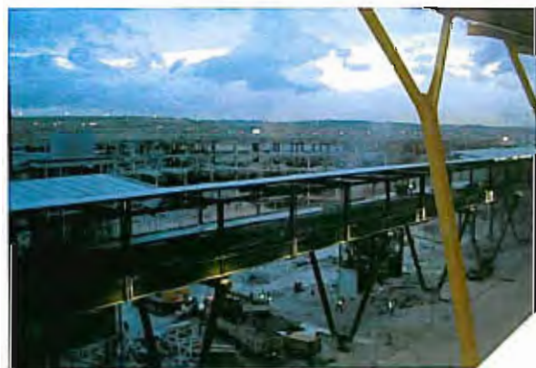
Efectos en el aparcamiento D de la T4 del Aeropuerto de Barajas del atentado con coche-bomba de la organización terrorista ETA en las Navidades de 2006.
