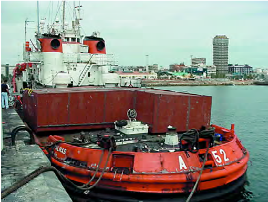
Aspecto de la toldilla con el nuevo casetón de habitabilidad ya instalado.
