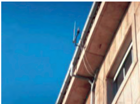
Fig. 5a.—Antenas AIS, GPS y VHF.
