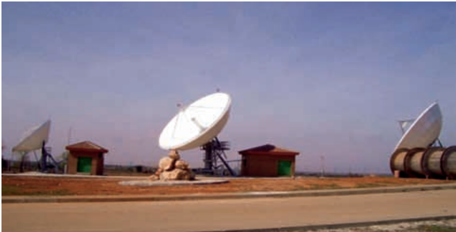
Fig. 3.— Campo de antenas satélite en Bermeja.
