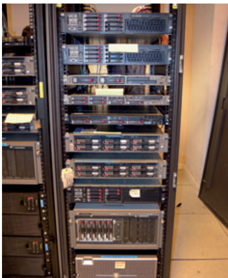
Rack de servidores del CGA.
