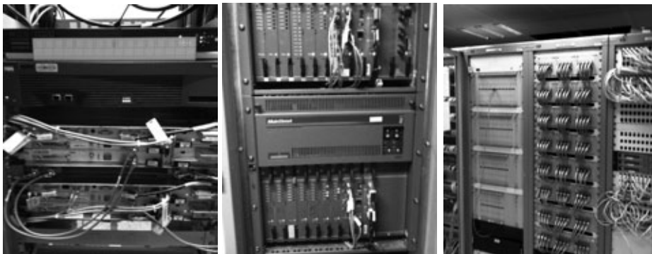
Equipos típicos router y fleximux usados para manejo de datos.
