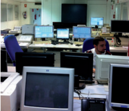
Sala de control de comunicaciones típica en remoto.
