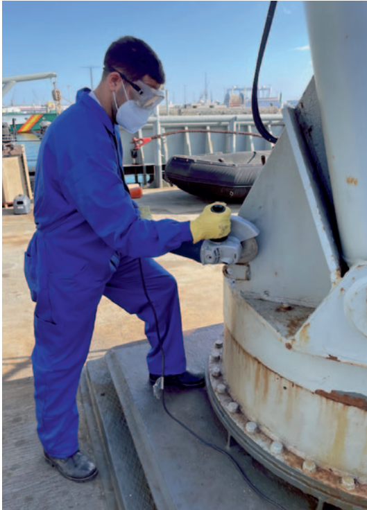
Realizando un mantenimiento con una máquina amoladora a bordo de un buque de la Armada. (Fotografía facilitada por el autor)
