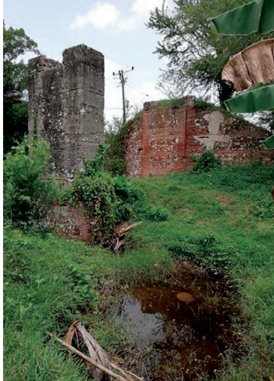
Restos de Puente de la Bemajagua, Aguas Claras. (Fotografía facilitada por el autor)
